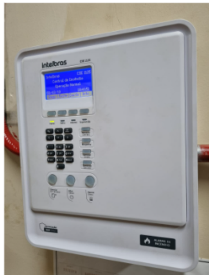
Alarme de Incêndio.
