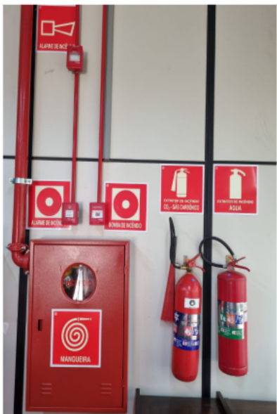
Caixa de Hidrante e proteções contra incêndio.
