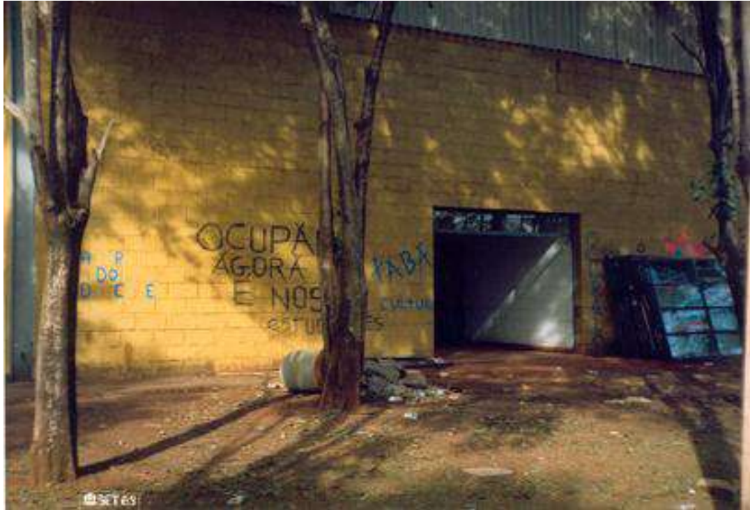
Figura 7 – Fachada do prédio do Arquivo Central pichada em decorrência da invasão pelos alunos, em setembro de 1989. Arquivo Central/SIARQ-Fundo UNICAMP/Grupo CIDIC.
